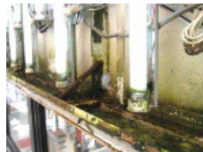
内照式看板内部の腐食
