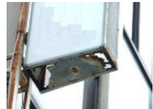
看板底部の留め具の破損
