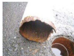
柱根元のサビを放置し、倒壊
