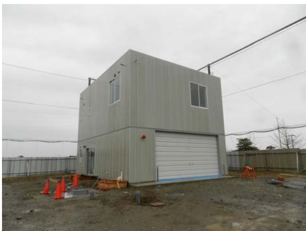
建設中の中泉方面隊第3分団コミュニティ消防センター
