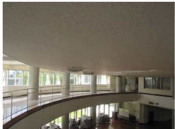
童洋中学校多目的ホール(落下防止対策)
