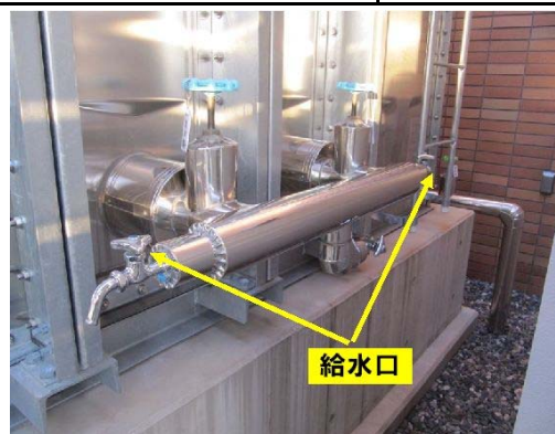
蛇口を設置した受水槽
