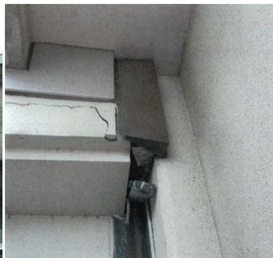
校舎ジョイント部の劣化(豊田中学校)
