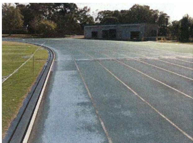
陸上競技場の傷んだレーン
