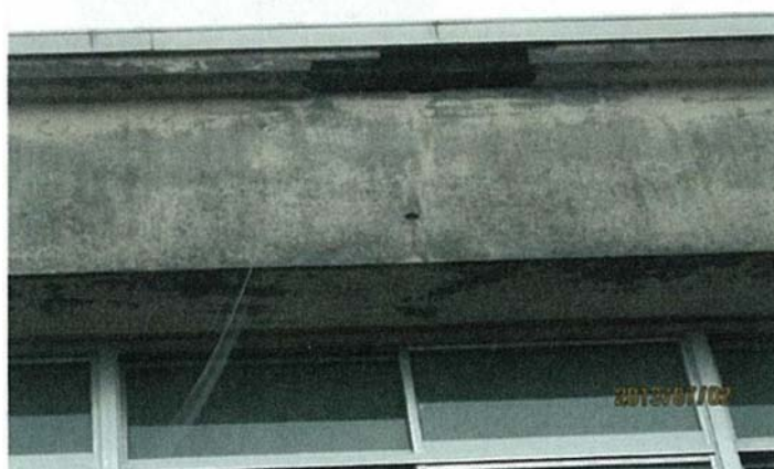
校舎上部の剥離落下跡(豊岡北小学校)
