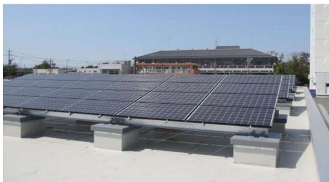
太陽光発電設備(市役所 防災センター屋上)
