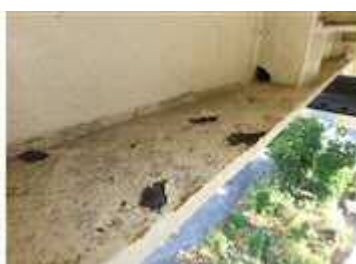
主桁の防食機能の劣化
