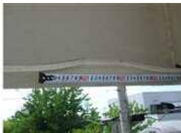
桁の変形・欠損
