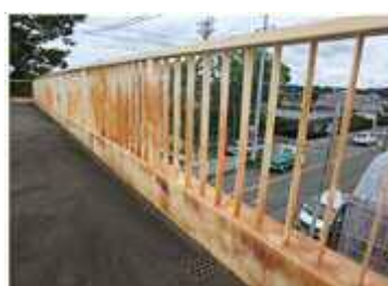
地覆の防食機能の劣化
