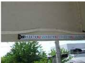
桁の変形・欠損
