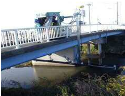
[ロボット技術を使用した例：野箱大橋歩道橋 令和元年度 橋梁点検業務]
