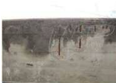
床版の鉄筋露出
