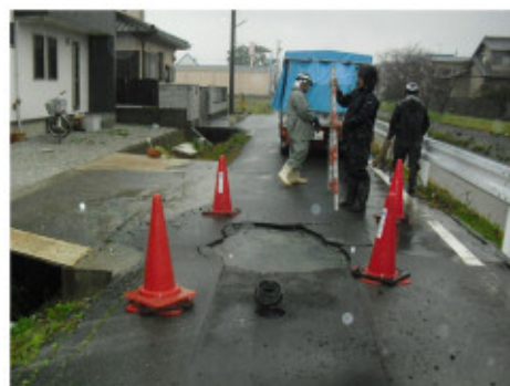
● 道路での漏水事故
