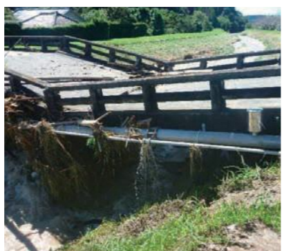
敷地川下田橋の被災の様子
