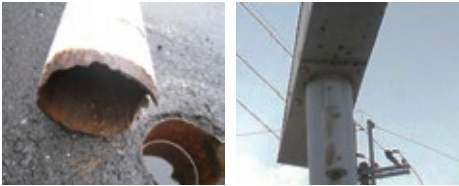
▲柱根元のサビを放置し、倒壊 ▲看板本体からポールへの汚ダレ
