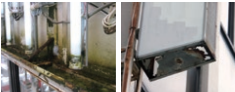
▲内照式看板内部の腐食 ▲看板底部の留め具の破損
