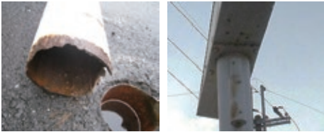
▲柱根元のサビを放置し、倒壊 ▲看板本体からポールへの汚ダレ
