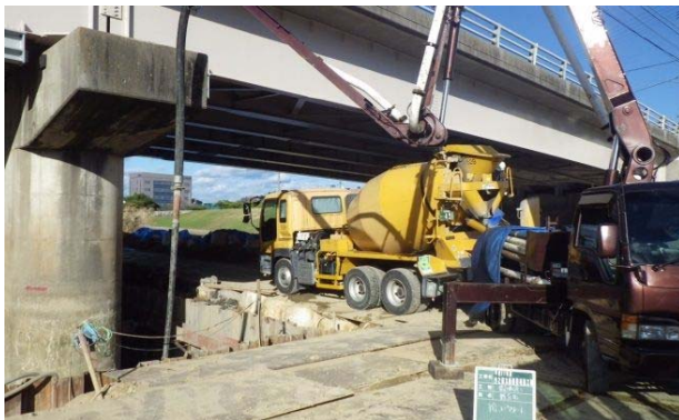
6.橋梁の補修・長寿命化の推進 (今之浦大橋での工事の様子)
