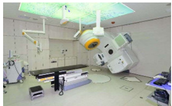
8. 磐田市立総合病院 放射線治療器の更新 （現在導入されている放射線治療器）
