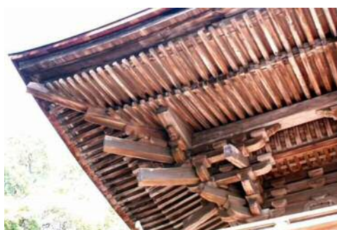
下から見上げた屋根：部材を複雑に組み合わせさせた三手先斗栱(右下)と二軒で整然と並んだ垂木の様子がよくわかります
