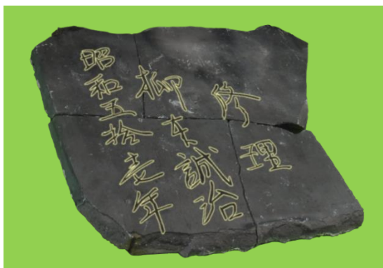
台風で崩落した板瓦 (字が見やすいよう画像を加工しています)
