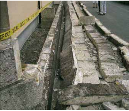
▲地震により倒壊したブロック塀
