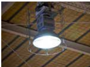
▲体育館の高圧水銀ランプ
