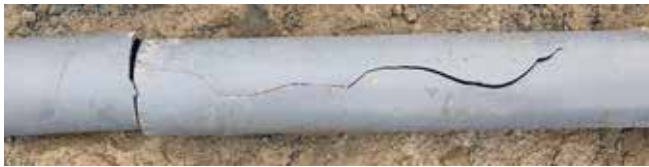
▲劣化により裂けてしまった水道管
