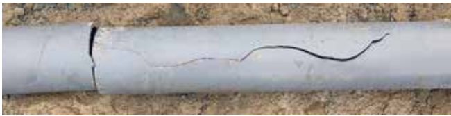
▲劣化により裂けてしまった水道管
