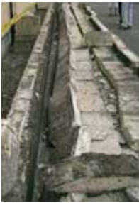
▲地震で倒壊したブロック塀
