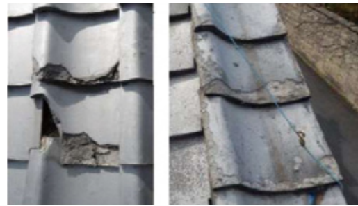
瓦が著しく破損している例
