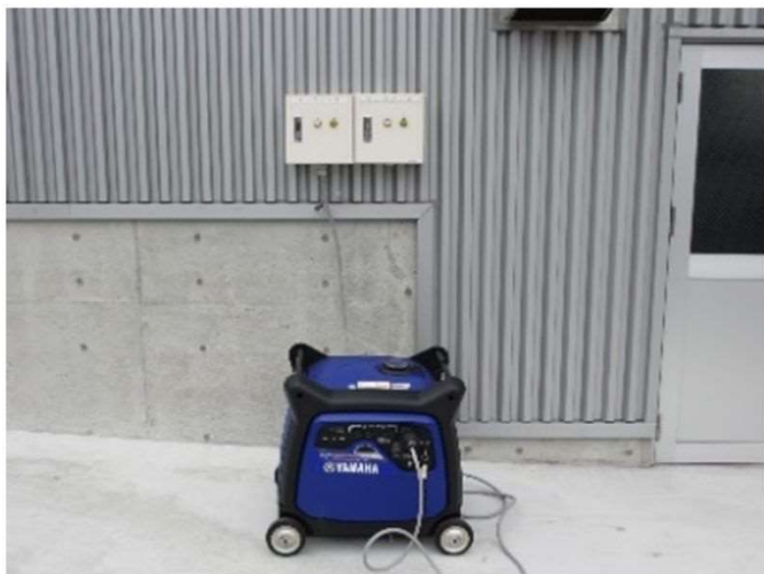
避難所非常用電源
