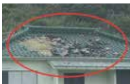
▲被害を受けた瓦屋根 出典：(一財)日本建築防災協会
