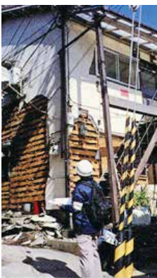
▲地震で被災した家屋
