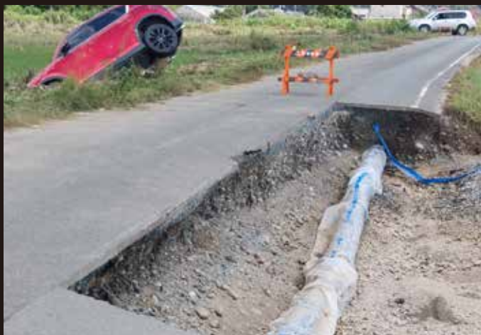
舗装が削られ、水道管があらわに。自動車は路肩に転落していた。(上神増)
