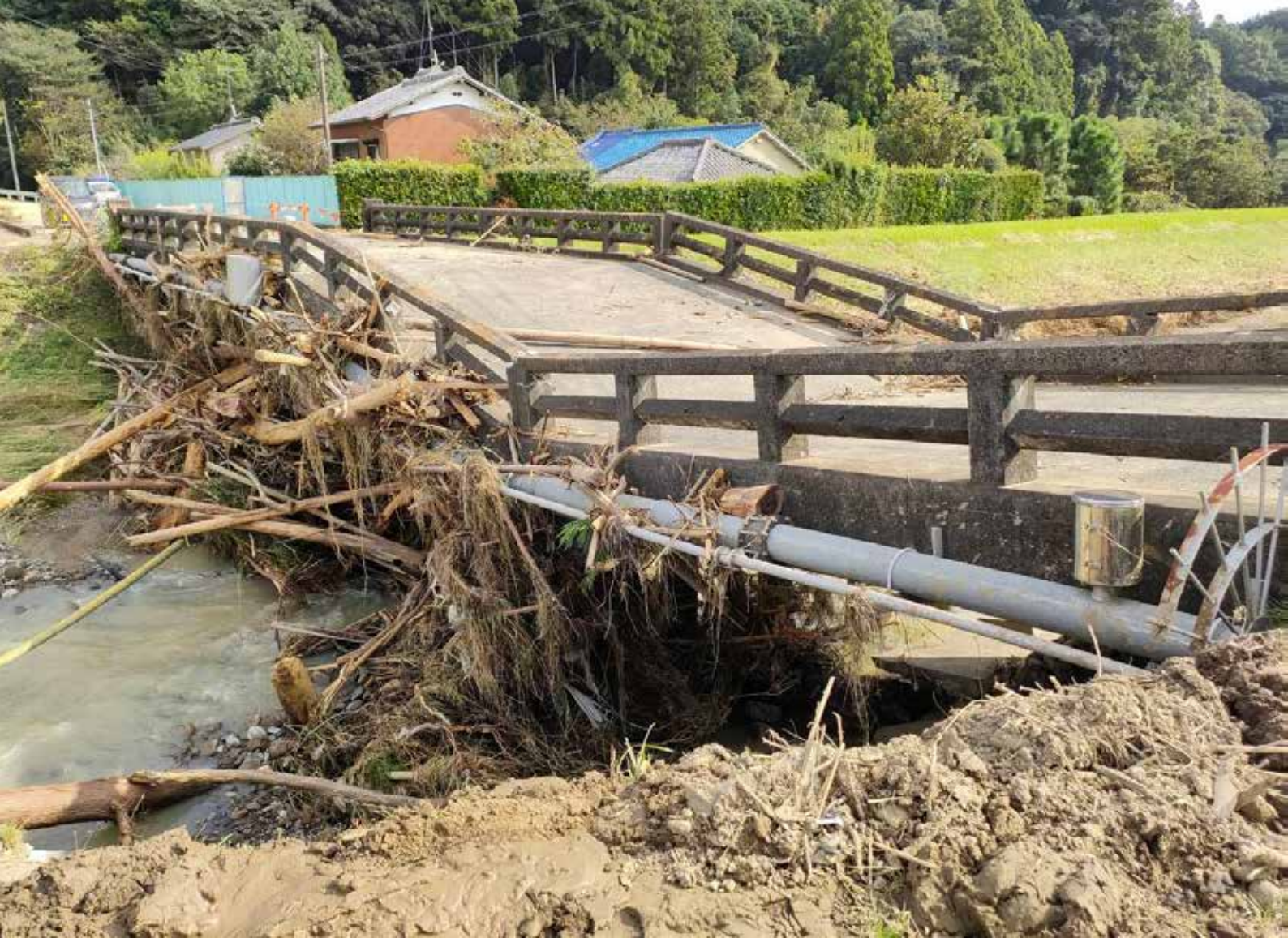
敷地川に架かる下田橋。増水により橋脚が破損し、橋げたは折れ曲がった。(家田)
