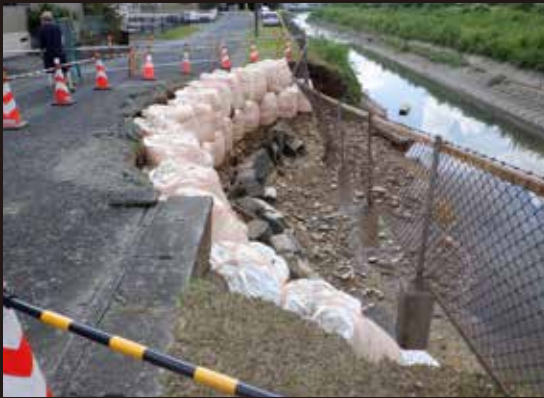
基礎部分が削られ、フェンスが宙に浮いてしまった。(大久保)
