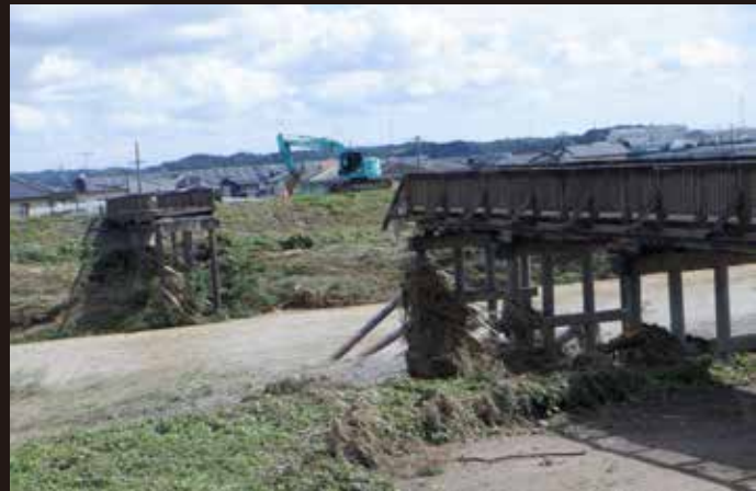
太田川に架かる新屋橋は一部が流失した。(向笠新屋)
