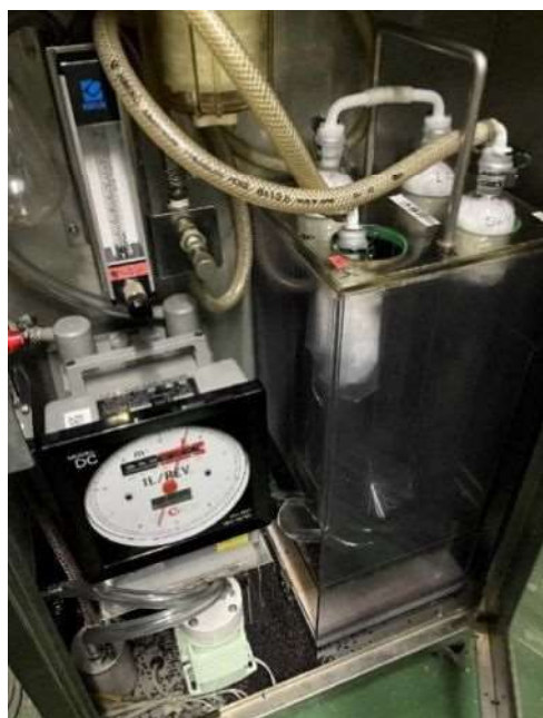
写真1 カラムの破損状況
