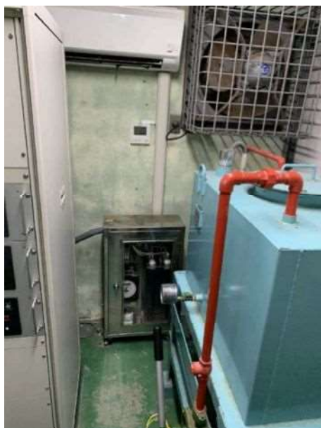
写真4 白砂局舎内の状況
