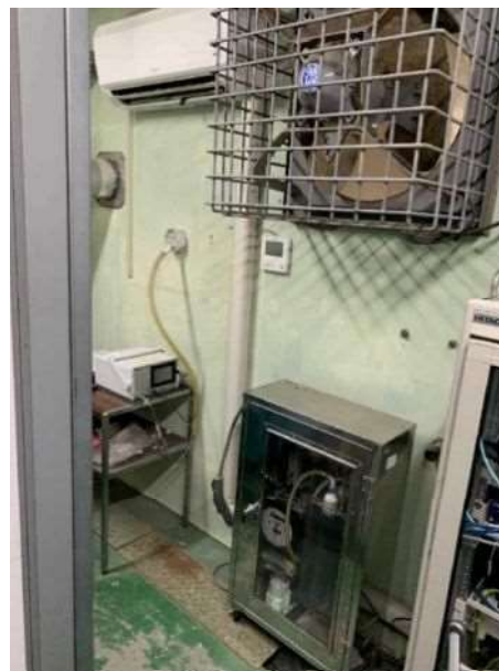
写真5 平場局舎内の状況
