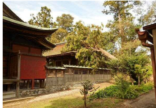
写真 92 淡海国玉神社本殿の倒木 平成 23 年
