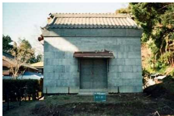
写真 49 修理工事前 平成4年
