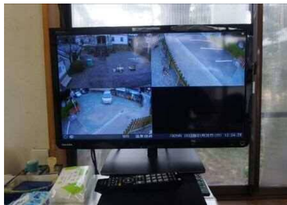
写真 46 防犯カメラ（屋内モニター）
